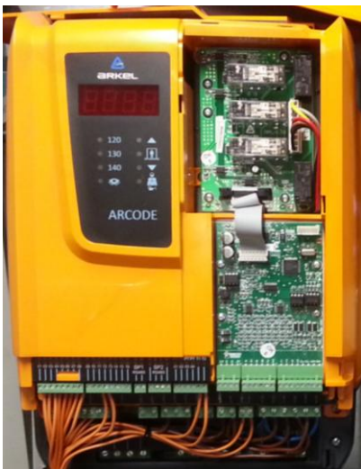
Bild 4. Styrsystem / frekvensstyrning - Arcode (integrerat i samma enhet), monterad i apparatskåp.
