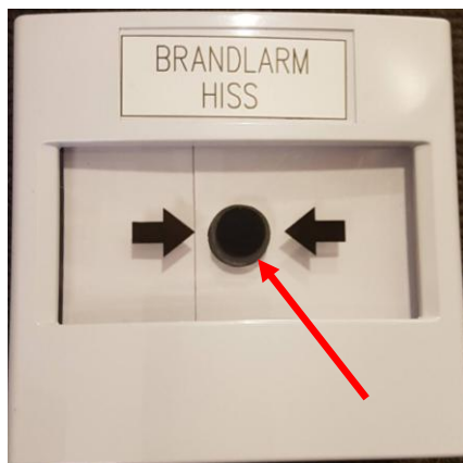
Bild 11. Brandlarmstablå med opåverkad brandlarmsknapp.
