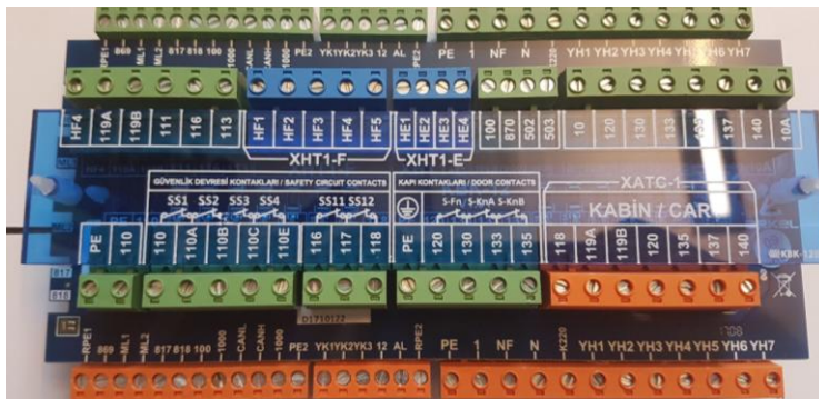
Bild 3. Plintkort i apparatskåp, för bl. a hängkabelanslutningar (orange plintar). Plintkortet är modifierat beroende på krav i EN81-20 och kallas KBK12 och KBK13.
