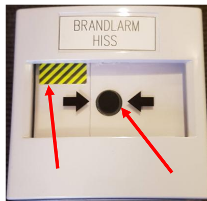
Bild 12. Brandlarmstablå med påverkad brandlarmsknapp och gul-svart indikeringsflagga.
