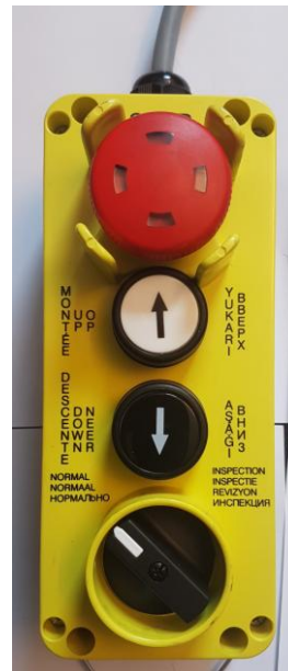
Bild 6b. Återkörmingshandtag i elskåp. Notera skillnaden mot Inspektionshandtagen vid taklåda och vid groplåda!
