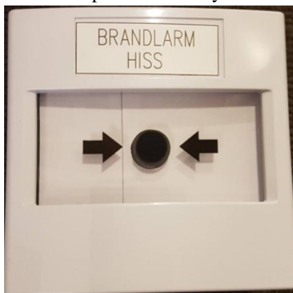
Bild 8. Brandlarmstablå i anslutning till schaktdörr vid hissens Entréplan.
